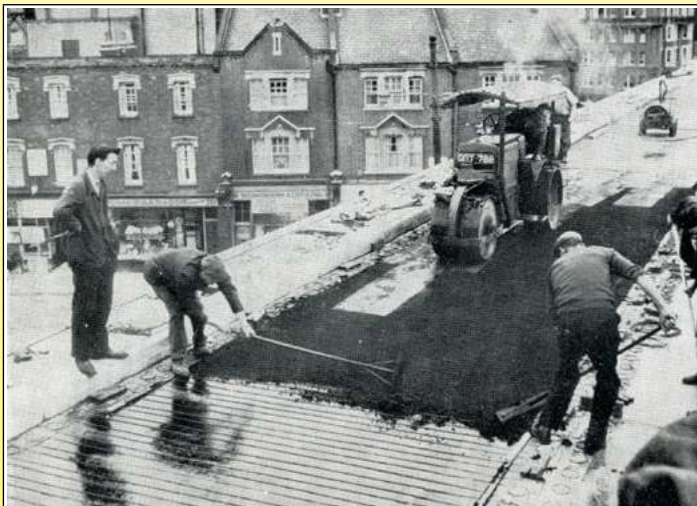
1969 Укладка асфальта на верхнюю проезжую часть развязки Хаммершмидта в Лондоне (Электрический подогрев проезжей части, Роберт Феликс, 1971 г., Музей Ultimheat*)
